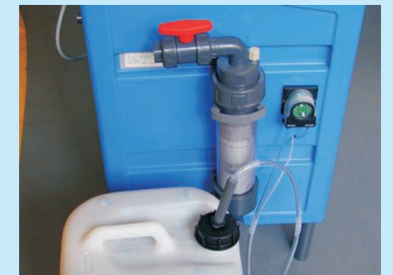
Particolare del filtro e della pompa per l'ACIQEST
